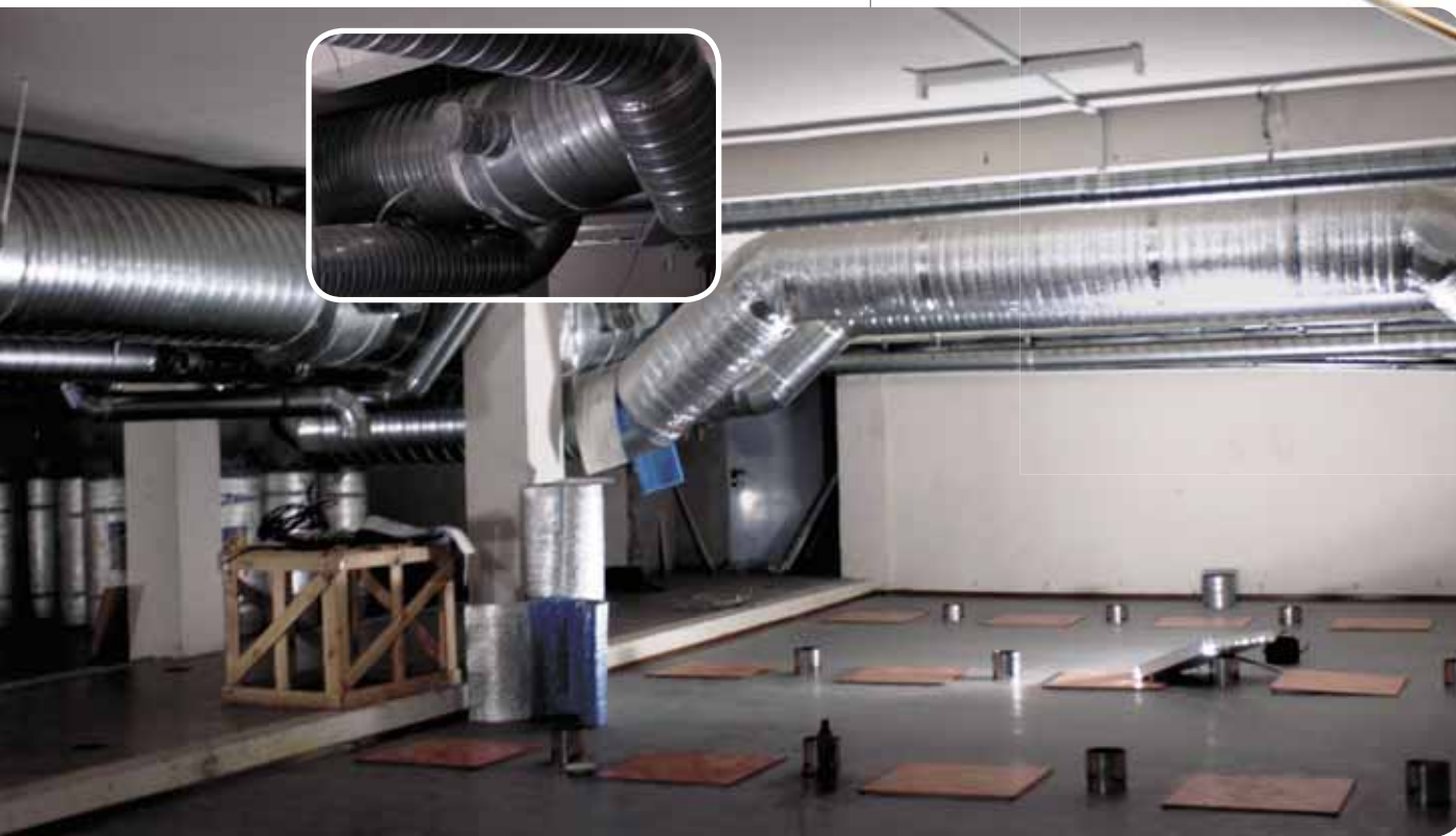
Технический этаж Центра со сложной системой фильтров будет обеспечивать надлежащие условия для содержания животных
